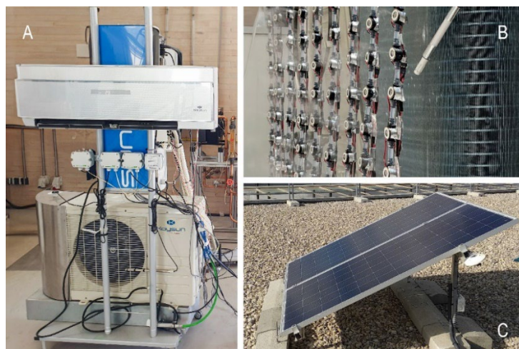
Figura 3. Prototipo de sistema de aire acondicionado solar con pre-enfriamiento del aire de entrada al condensador mediante atomización por ultrasonidos.
